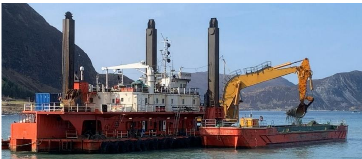
Figur 5-5 Utdjupeing vil bli utført frå eit mudringsfartøy. Steinmassane som blir sprengt ut blir teke opp og mellomagra på lekter før dei blir frakta til eit regulert deponi på sjøbotn eller til eit område på land.
