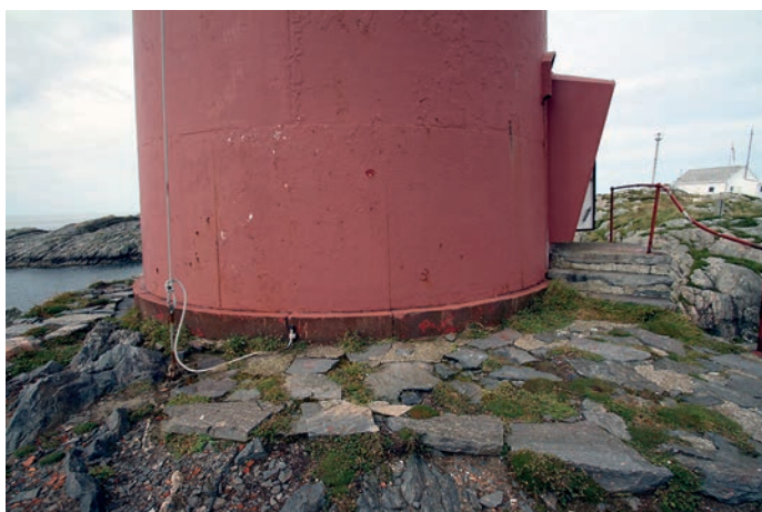
Inngangspartiet med avfuktingsanlegget.
